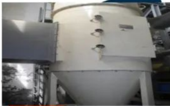
除尘器的泄压
