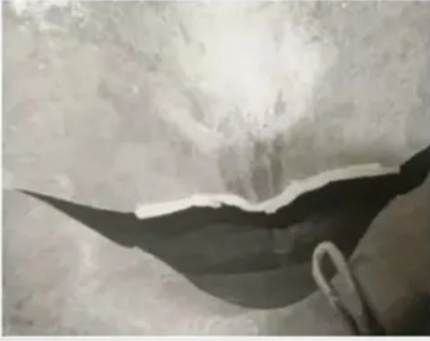
锅炉内胆开裂
