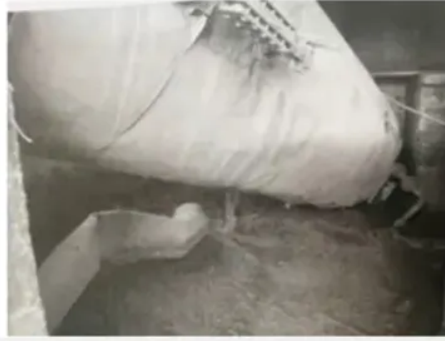
倾倒后的锅炉筒体
