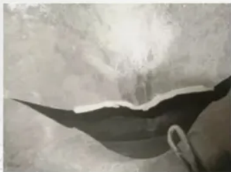
锅炉内胆开裂
